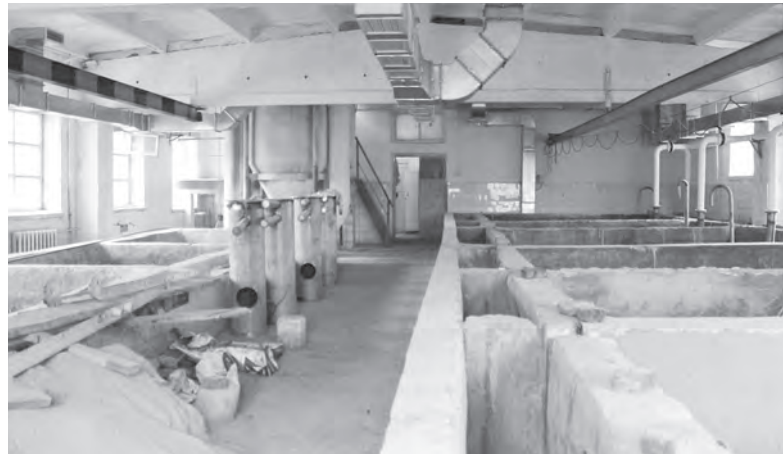
В фильтровальном зале станции водоподготовки, где должны идти ремонтные работы, в понедельник, 13 июля, не было ни одного рабочего
